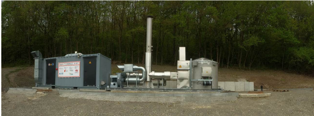
neue Schwachgasbehandlungsanlage Deponie Stäffelsrain – seit Oktober 2017
